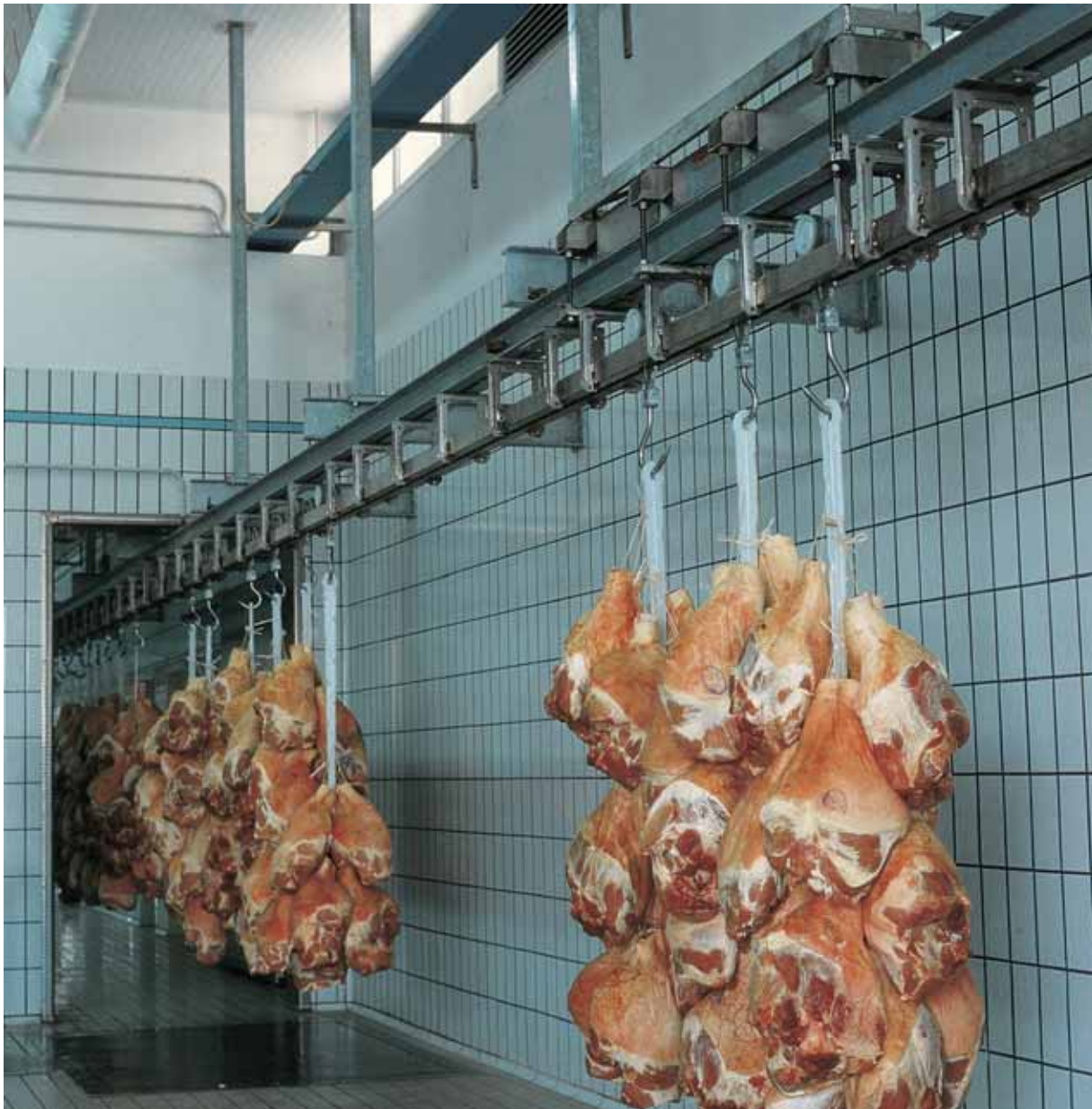
Pesetta aerea AR-TC installata in un reparto ricevitore prosciutti di un moderno salumificio
